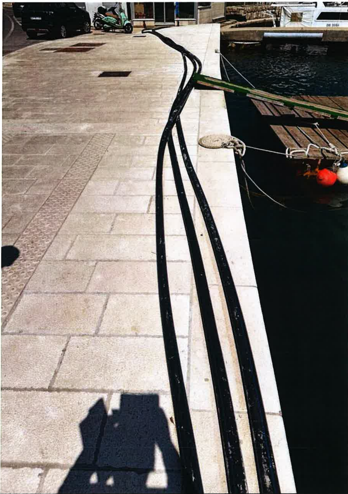
Slika 10. Kabeli privremenog priključka - segment treći.
