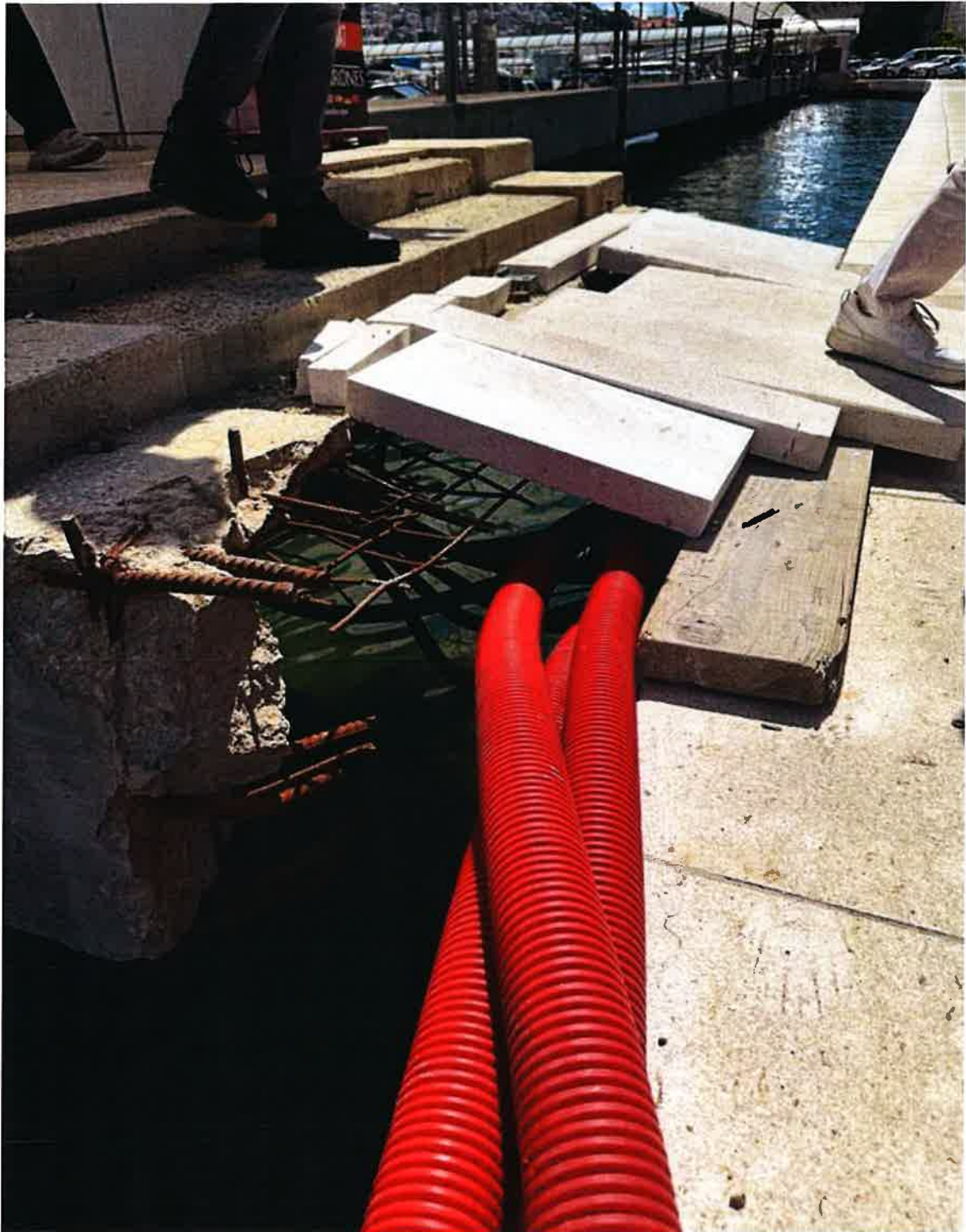
Slika 8. Kabeli privremenog priključka - segment prvi.
