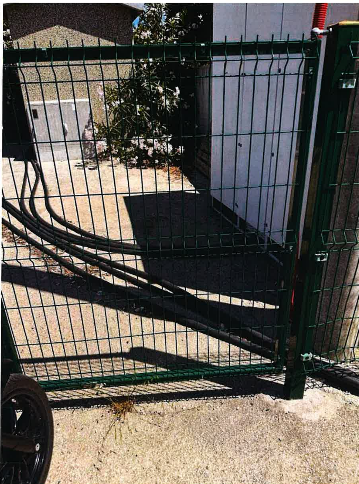
Slika 1. Prostor ispred Glavnog razvodnog ormara unutar ograđenog prostora trafostanice.
