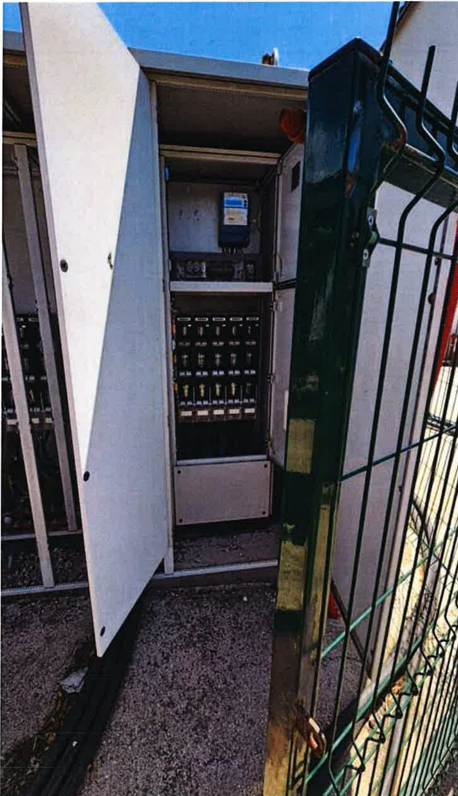
Slika 2. Glavni razvodni ormar - mjerna sekcija i sekcija s dovodnim kabelima.
