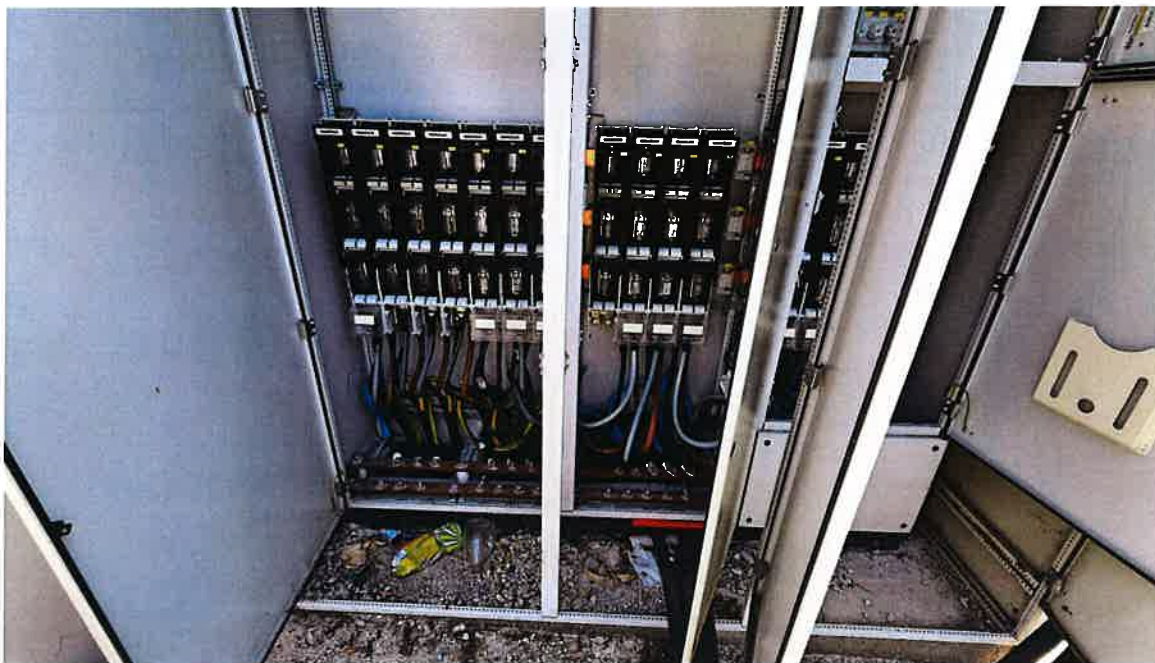
Slika 3. Glavni razvodni ormar - sekcija s odvodima
