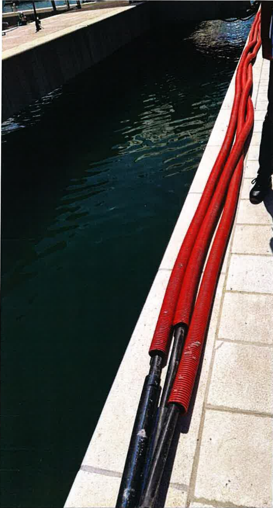
Slika 9. Kabeli privremenog priključka - segment drugi.
